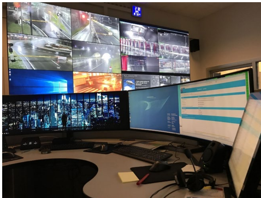
Bilde 1: 110 nødsentralen i midten av SAMLOK Nord på Albertmyra
